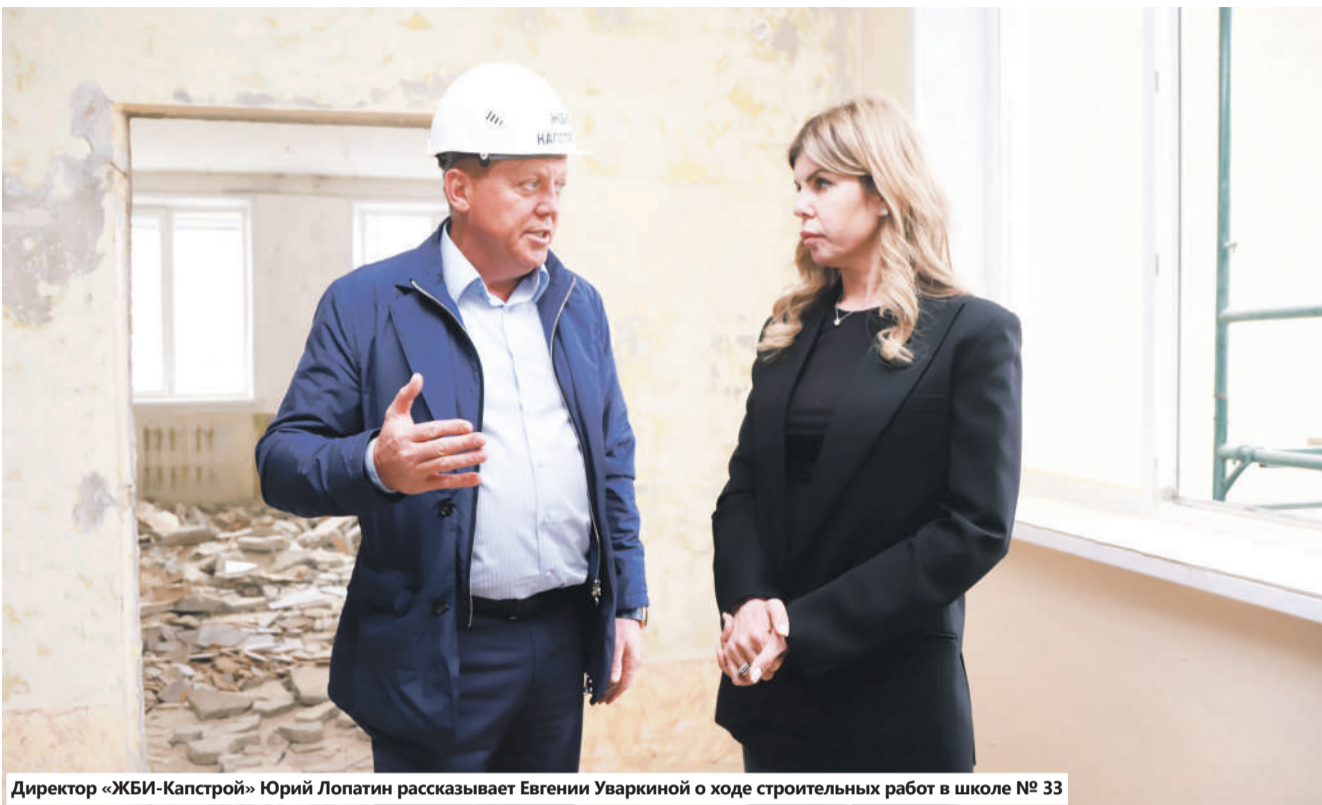
Директор «ЖБИ-Капстрой» Юрий Лопатин рассказывает Евгении Уваркиной о ходе строительных работ в школе № 33
